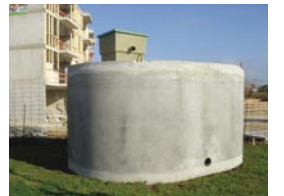
Citerne de récupération des eaux de pluie
